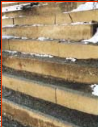
Auf den desolaten Treppen starb beim Bergiselspringen 1998 ein Mensch
